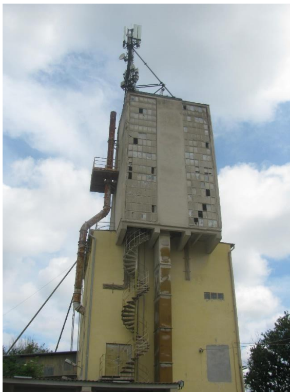
Zał. nr 1: Widok ogólny instalacji radiokomunikacyjnej.
