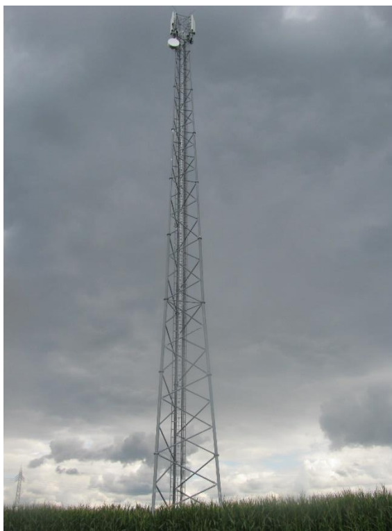
Zał. nr 1: Widok ogólny instalacji radiokomunikacyjnej.
